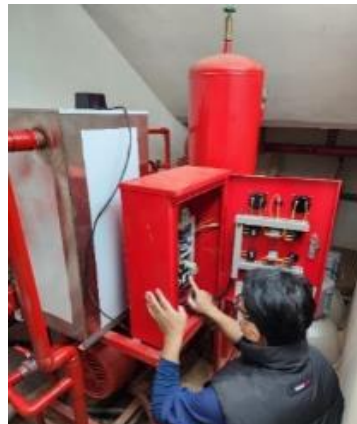
消防泵浦系統
