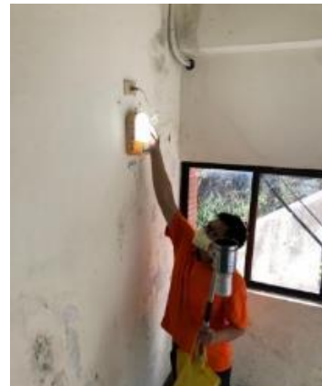
緊急照明燈具
